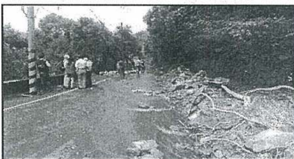
地點：華梵大學下方大崙路 災害情形：野溪沖刷至路面
