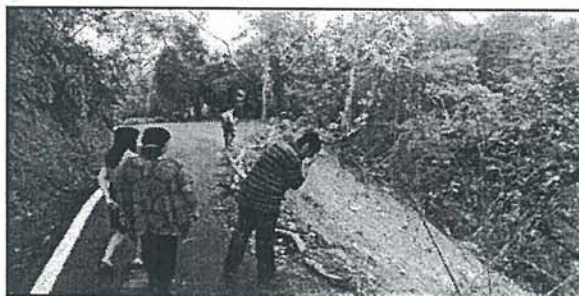
地點：格頭里竹坑農路 災害情形：下邊坡滑動路面破損
